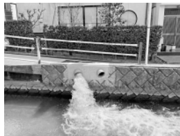
ポンプ設置後の高瀬川排水のようす
