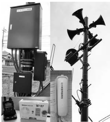
コミュニティセンターに設置された防災行政無線システム
