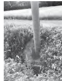
防草対策として1m四方がコンクリート化された電柱
