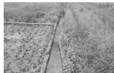
修繕が必要な農業用排水路
