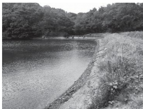
老朽化が進む防災重点ため池
