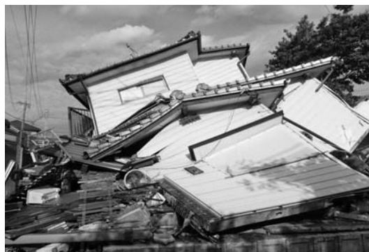
熊本地震で倒壊した住宅
