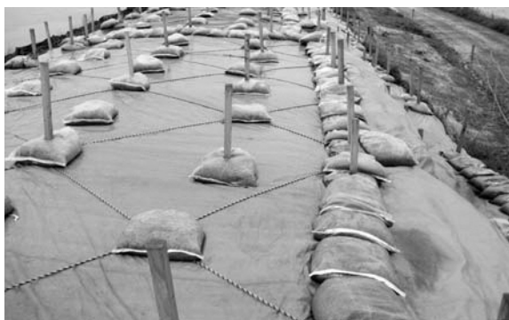
ブルーシートと土のうで修復された堤防の亀裂 (霞ヶ浦・茨城県)
